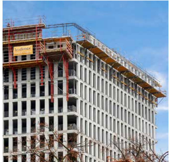
Die Montage der Faltbühne FB 180 vor Ort gestaltete sich als unkompliziert und schnell, da sie bereits vormontiert auf die Baustelle geliefert wurde.
